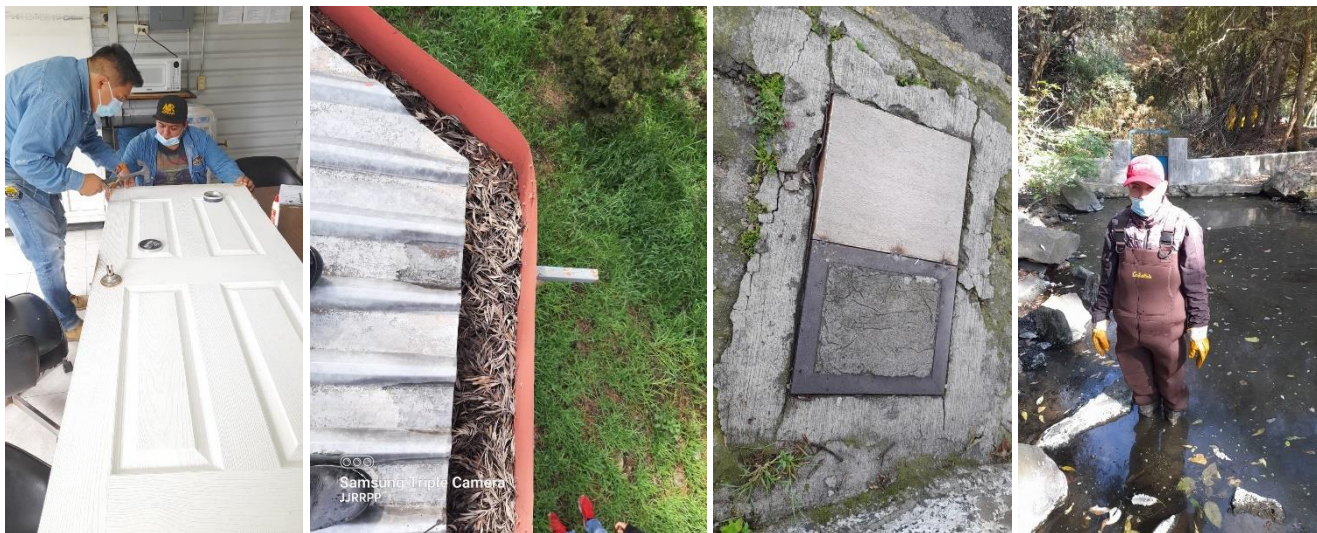
Fig. 9. Acciones de mantenimiento de las instalaciones de Canter Oriente por parte del personal de DGOC, en coordinación con la SEREPSA.
