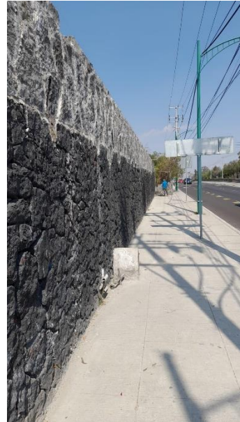
Fig. 34. Vista exterior de los trabajos realizados en la barda de la ZNP colindante con Av. Insurgentes.
